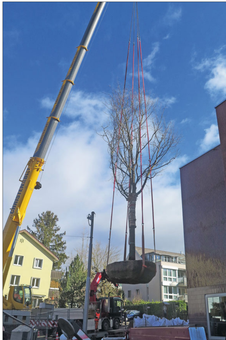
Die neue Wesemlin-Eiche schwebt heran. Der imposante Baum wird mit einem Kran in die richtige Position gebracht, bevor er in die vorbereitete Grube vor dem neuen Quartierzentrum eingesenkt wird. Foto: Urban Schwegler
